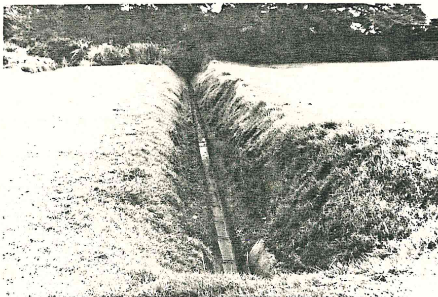
SISTEMA DE DRENAJE PLUVIAL EN CIUDAD ARCO IRIS (MEDIAS CAÑAS)
